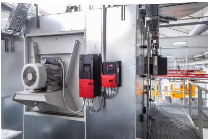
Abb. 7 Lüftungsgeräteantrieb mit FU
