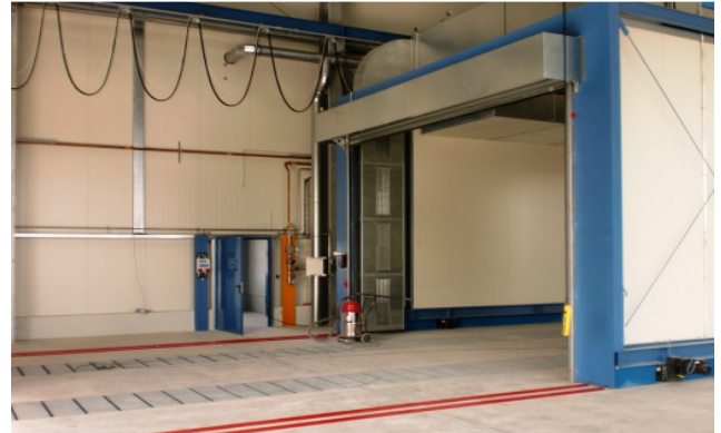
Abb. 1 Absaugbodenkanäle und Verfahrrockner
