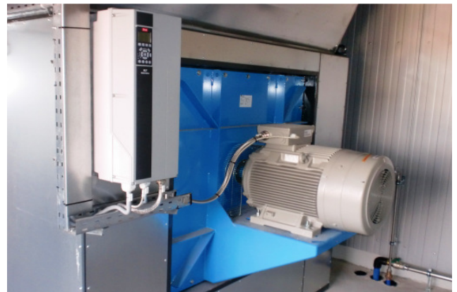
Abb. 3 Ventilatorantrieb mit FU
